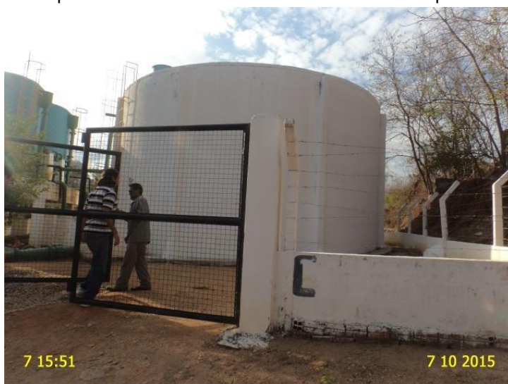
Figura 38 - Reservatório apoiado RAP-01 do SAA de Deserto no município de Itapipoca - CE.
