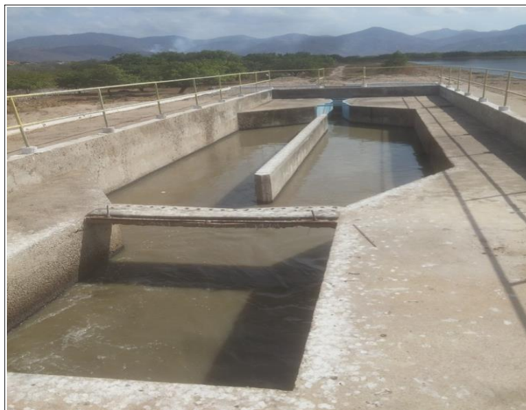
Figura 59 - Unidade de tratamento preliminar (gradeamento, caixa de areia e Calha Parshall) do SES da Sede do município de Itapipoca – CE.
